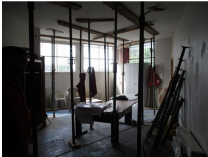
Photo 7 : Pieds-droits pour consolider le faux plafond.
